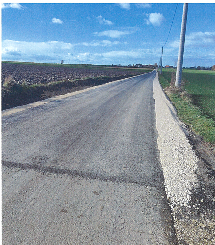
Zdjęcie 10. Remont drogi gminnej w miejscowości Chebdzie Nr 350010T odcinka w km 1+245 - 1+955
