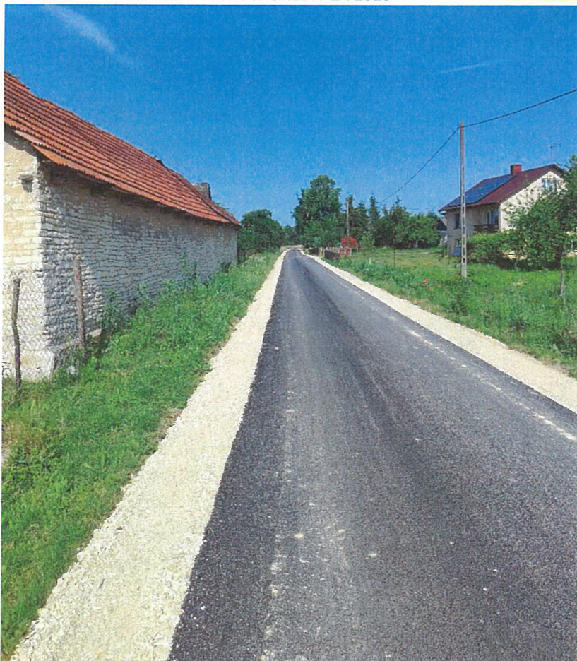
Zdjęcie 3. Modernizacja drogi gminnej w miejscowości Chlewska Wola nr 350038T na odcinku o długości 250 m – po zakończeniu robót budowlanych
