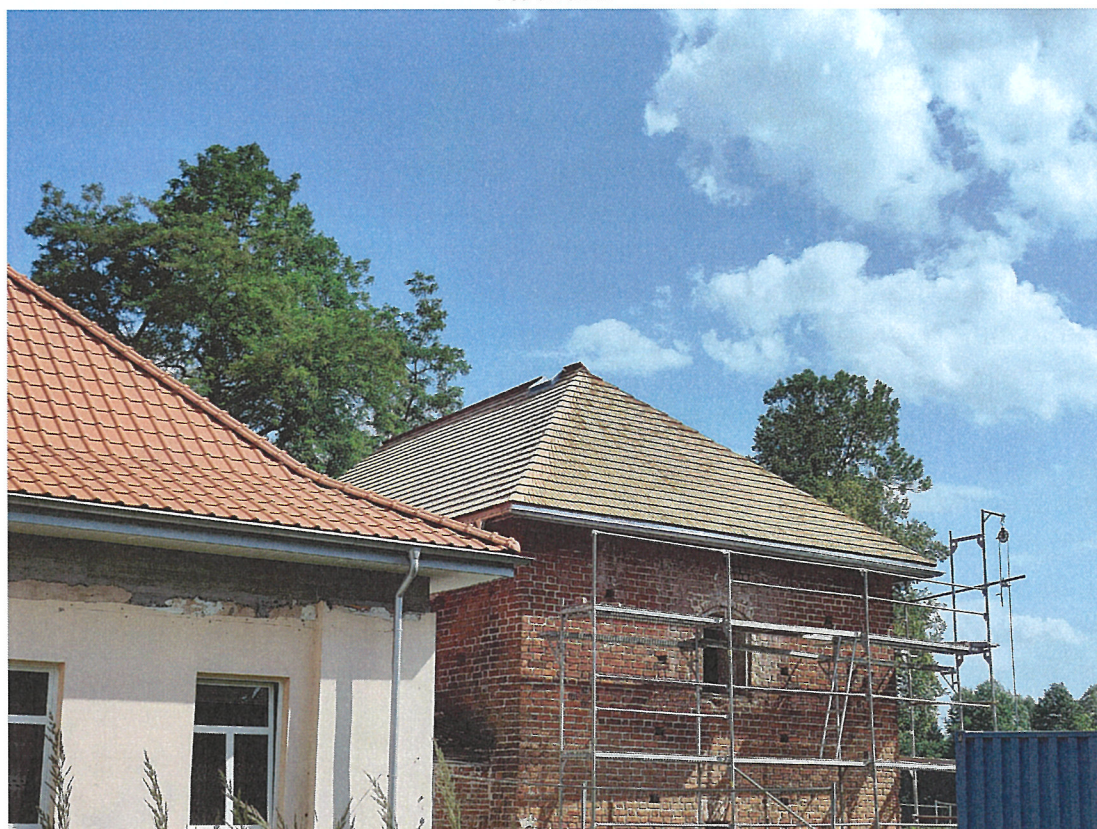
Zdjęcie 12. „Rewaloryzacją zabytkowego obiektu tzw. Murowańca w Moskorzewie” – w trakcie robót budowlanych
